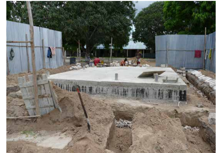
Der Wassertank ist betriebsbereit
